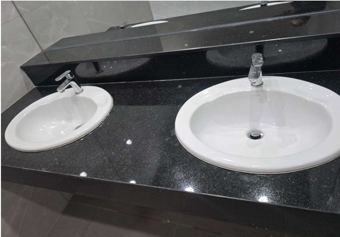
1.5 ก๊อกน้ำที่มีปริมาณการใช้น้ำไม่เกิน 6 ลิตร/นาที
